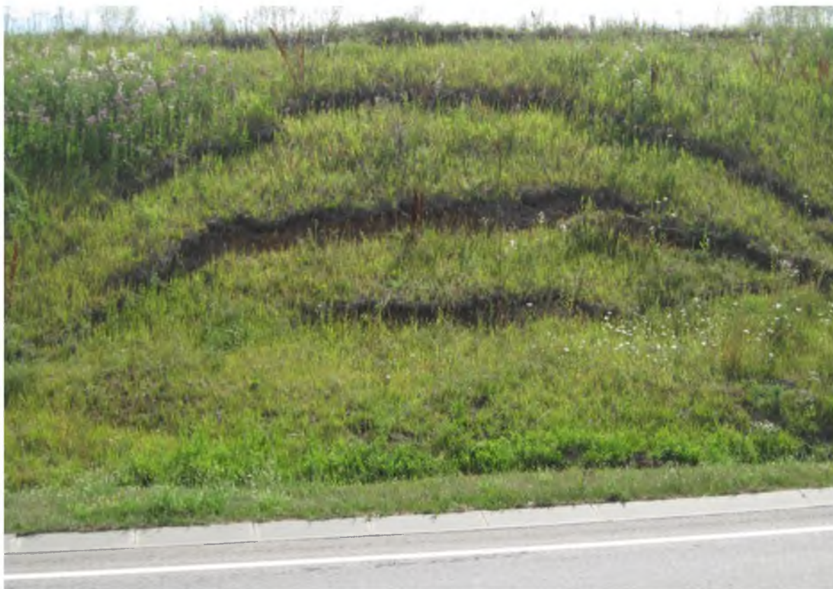
Рис. 2. Оползень на склоне выемки автодороги в Яковлевском районе Fig. 2. The landslide on the slope of the notch road in the Yakovlevsky district
